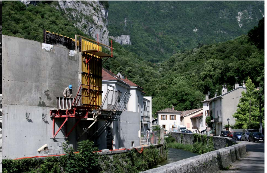
A GAUCHE : LA CONSTRUCTION DU THÉÂTRE EN ROND EN 1958 A DROITE : LA RECONSTRUCTION DU THÉÂTRE EN ROND EN 2007
